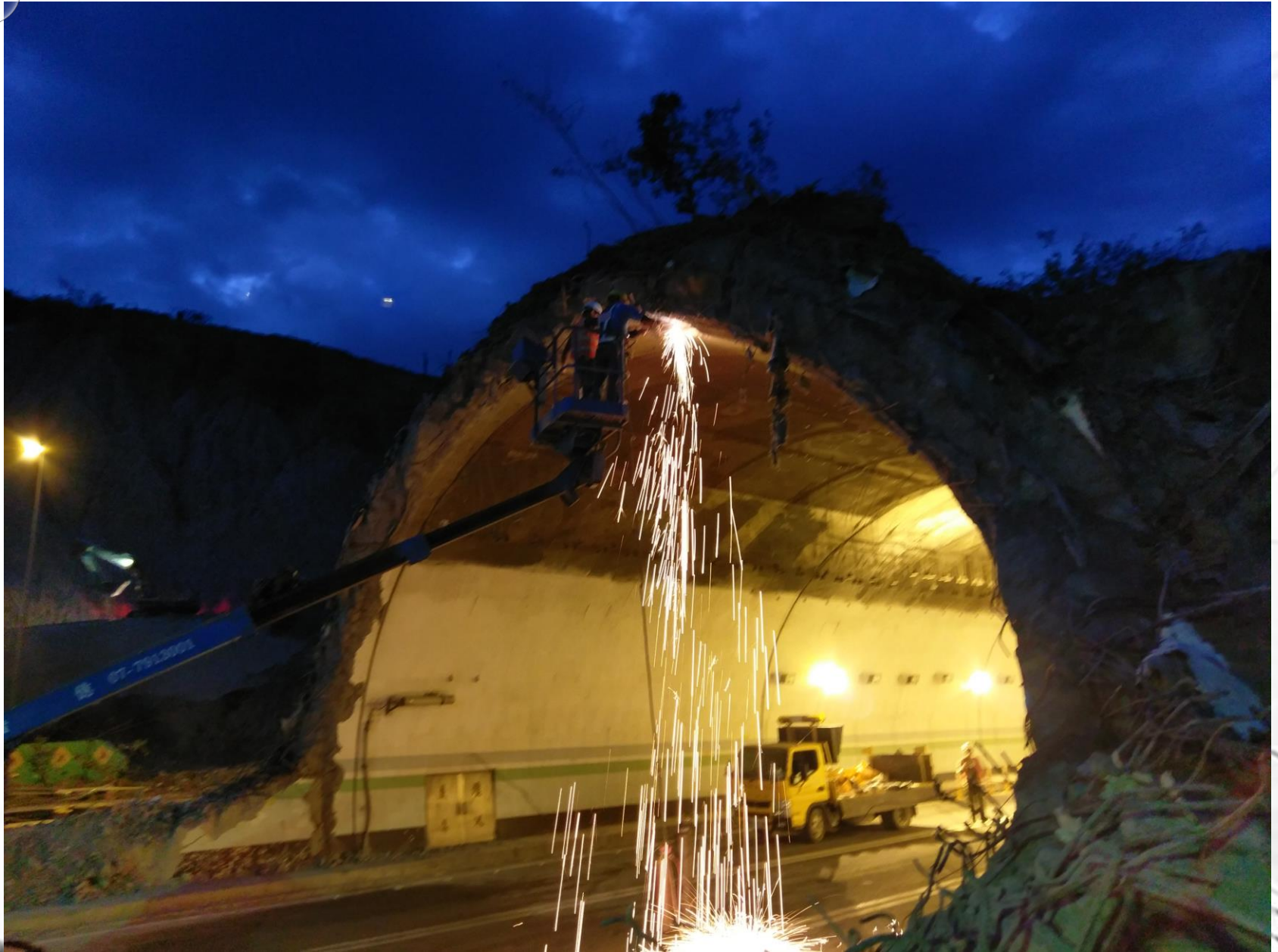
105公尺長隧道，要在13天完成拆除，且不能影響日間高速公路營運，故只能夜間施工，因此拆除過程必須小心謹慎，每個施工環節必須環環相扣，並且不能有不利影響營運安全之因素發生，以確保每日能準時安全開放通車。
