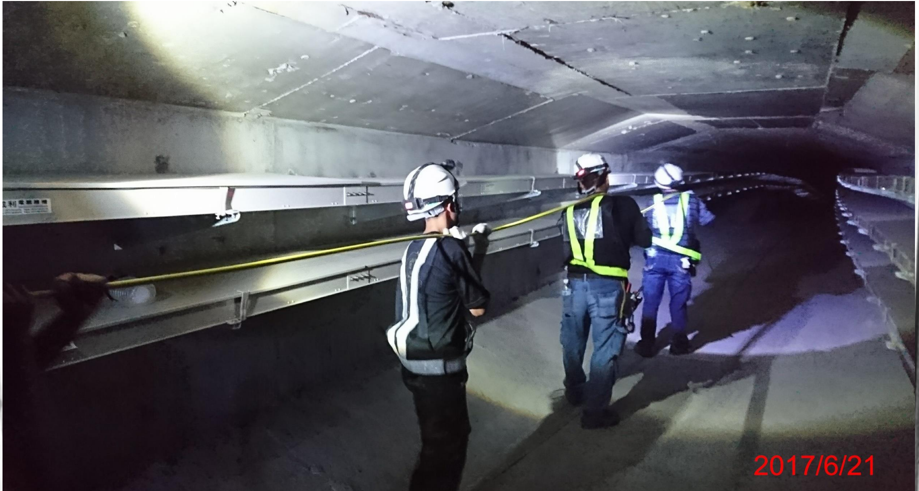
台9線蘇花公路交通控制系統工程為配合國家政策於107年農曆春節前通車，施工人員於炎熱6月天置身於東澳北溪橋箱涵內悶熱又密閉空間及空氣不良環境中仍然賣力佈設光纖纜線，在眾人同心合力下完成使命。
